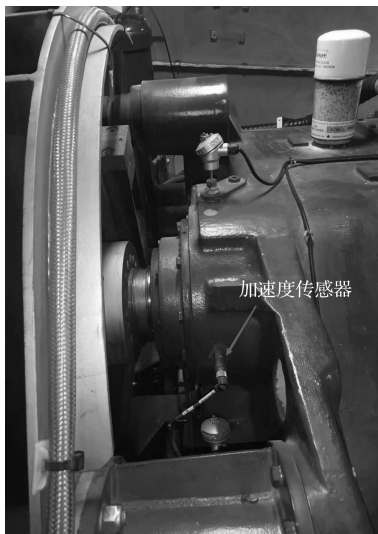
图3 风力发电机轴承现场测试图片
