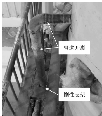
图 1 管道疲劳开裂图示
