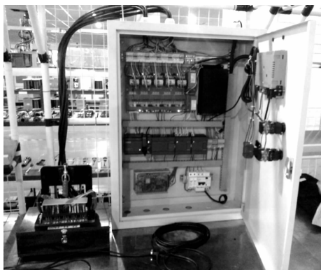
图7 控制柜实物图
