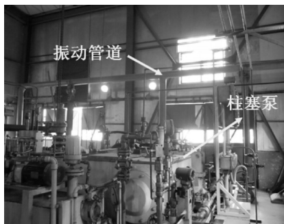
图7 柱塞泵进出口管道局部图
